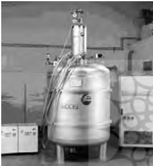
شکل ۶. تصویر یک ذخیره‌ساز ابرسانایی ۲ مگاژول
