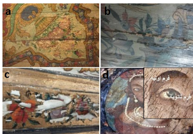
شکل ۱. جدایش لایه رنگ خانه زینت‌الملک (a)؛ ترک‌های نواری خانه صبار (b)؛ ترک‌های کاسه‌ای خانه صبار (c)؛ ترک‌های شبکه‌ای خانه محتشم (d)
