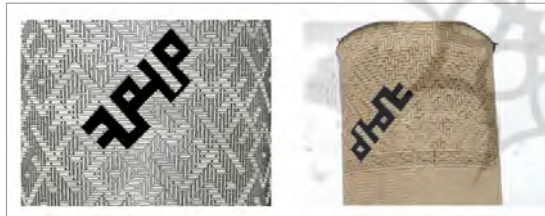
شکل ۶. استخراج کلمه «محمد» با خط کوفی بنایی ۱ در تزیینات تاج مناره فیروزآباد (نگارندگان، ۱۴۰۱)
