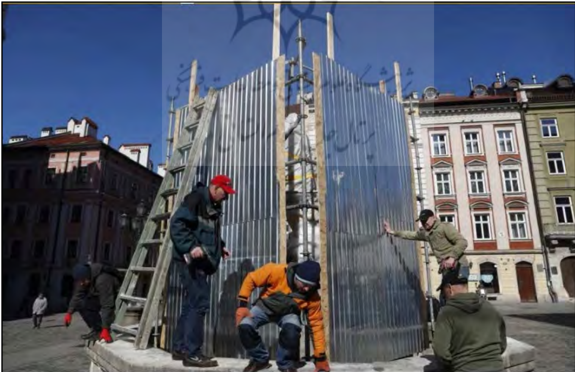
شکل ۵: ساخت یک مانع حفاظتی در اطراف یک مجسمه در لویو سال ۲۰۲۲ م. (RTS). Fig. 5: Construction of a protective barrier around a statue in Lviv in 2022 (RTS).
