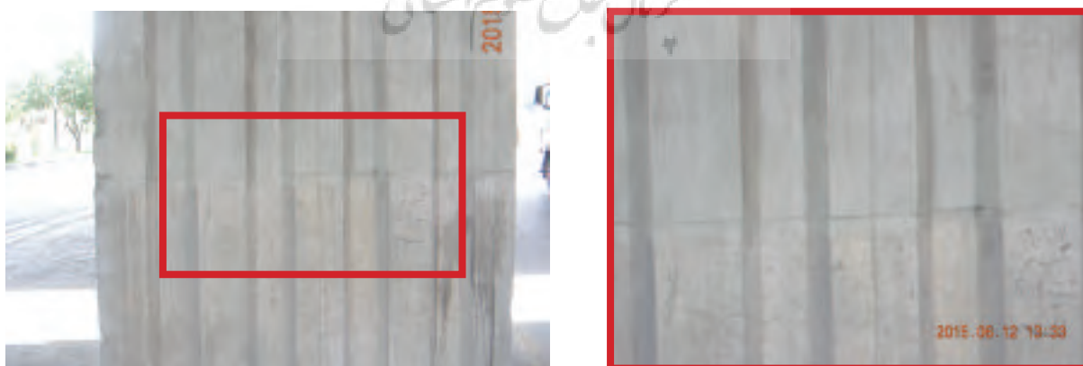
شکل ۳: اجرای پوشش مقاوم سیمانی ضد آب بر روی سطح بتنی (محدوده کادر قرمز رنگ تصویر سمت چپ) بزرگنمایی مرز بین پوشش مقاوم سیمانی ضد آب و سطح بتن طبیعی (تصویر سمت راست)
