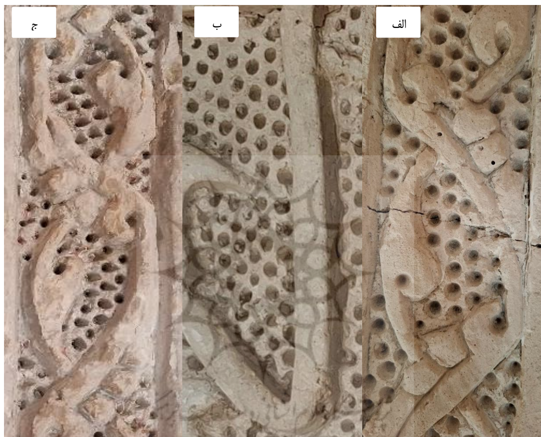
شکل ۹. آرایه گچی نقش‌گود: آژده کاری. الف: انتهایی کتیبه سوره الفتح. ب: کتیبه تاریخدار محراب. ج: ابتدای کتیبه سوره الفتح. تفاوت در شیوه اجرای آژده (الف و ب مشابه هم و هر دو متفاوت با ج). فقط ج اصالت تاریخی دارد.
