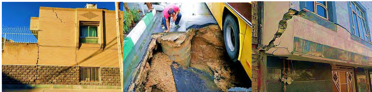
شکل (۱۷): تصویر سمت چپ ترک ساختمان در محدوده حصار کرج - تصویر میانی فرونشست در خیابان جمهوری به سمت میدان سپاه ضلع شمال شرقی باغ فاتح - تصویر سمت راست ترک بر روی ساختمان نوساز در حصارک پایین کرج
