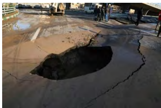
شکل (۲): فرونشست زمین در تاریخ ۱۴۰۰/۰۹/۱۲ در ساعت ۲ بامداد در منطقه شهری و تجاری شهرستان کرج - رجایی شهر
