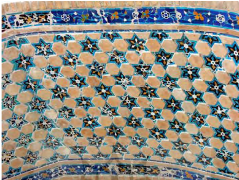
شکل ۳۳. جزئیات تزئینات معرق و آجری در ایوان ورودی زیارتگاه شهزاده عبدالله بن معاویه در هرات
