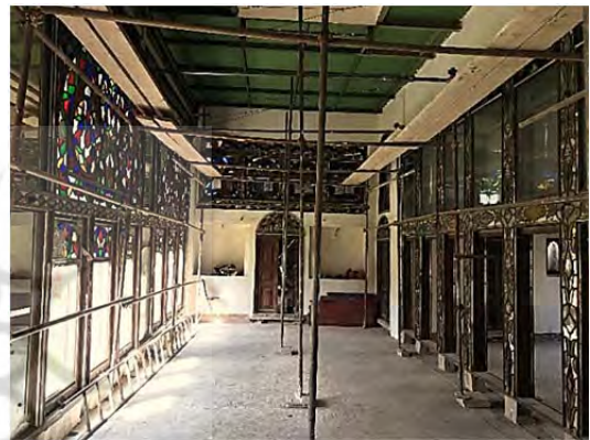
تصویر ۱۱: حسینیه مجتهد در حال مرمت (تصویر از مجتبی جوان اجدادی، کارشناس سازمان میراث فرهنگی اردبیل)
