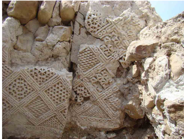
تصویر ۴: شواهد شکستگی دیوارها و آوار بر اثر زلزله (بایگانی شخصی عابدینی، مدیر پایگاه ملی غار تاریخی اسپهبد خورشید، ۱۳۸۸). Fig. 4: Evidence of broken walls and debris due to earthquakes (Abedini's personal archive, Director of the National Historical Cave of Espahbadkhorshid, 2010)
