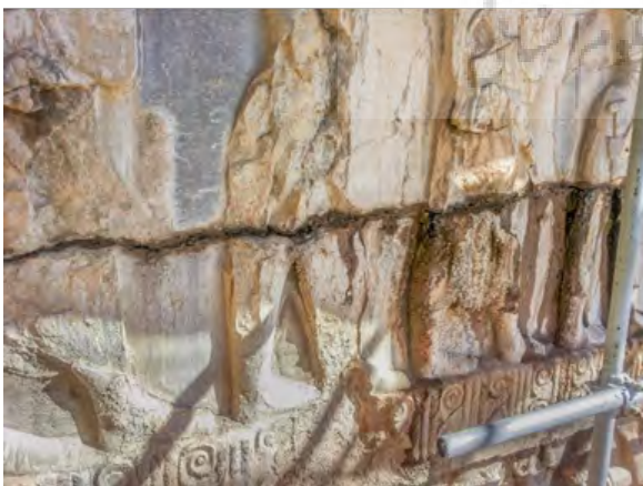
شکل ۴. شکستگی‌های ایجاد شده بر روی آرامگاه خشیارشا
