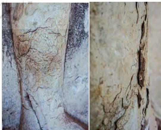
شکل ۵. آسیب لایه‌لایه شدن سنگ بر روی آرامگاه خشیارشا
