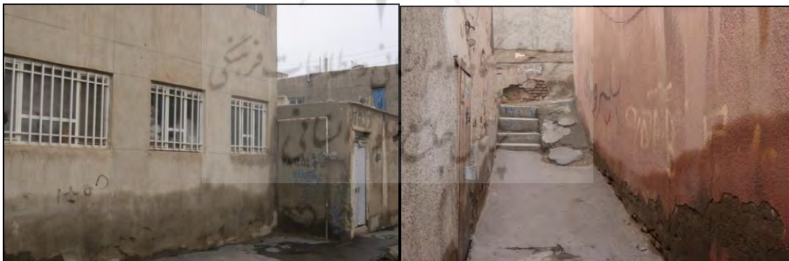
شکل ۷. آثار بالا بودن سطح آب زیرزمینی روی کف و دیوار منازل
