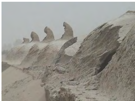
شکل ۱۵: سایش سقف مسکن بومی توسط ماسه‌ها
