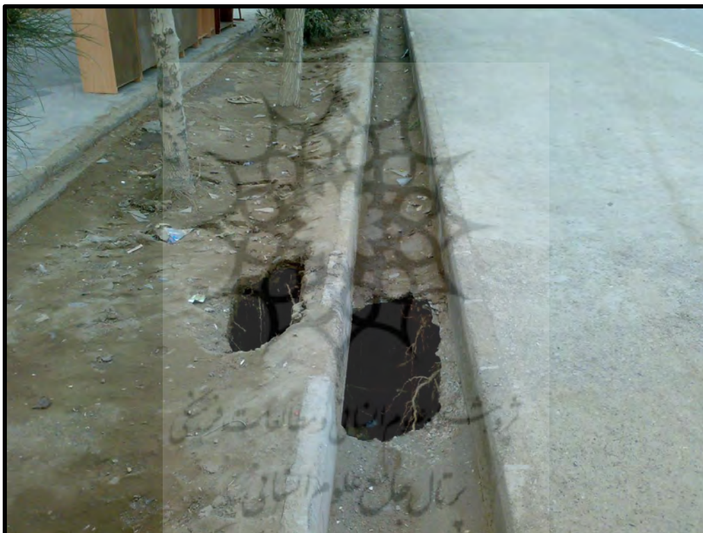
شکل ۱: نشست زمین در قنات‌های متروکه شهر سبزوار
