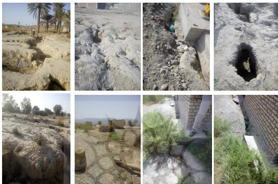
شکل ۱۳. الف، ب، پ، ت و ث: تصاویر مربوط به مخاطرات سایت جدید روستای شارب ماء و ج، چ، ح و خ: تصاویر مربوط به مخاطرات سایت جدید روستای سلیمان آباد
