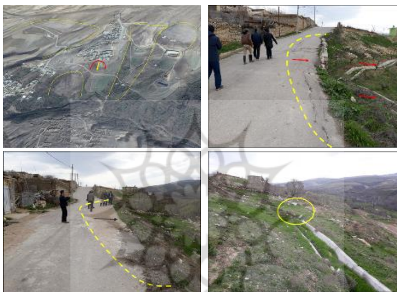
شکل ۱۷. الف: نمایی از زمین لغزش‌های قدیمی در اطراف سایت جدید روستای عرب، ب: گسترش ترک‌های کششی حاصل از لغزش در جسم جاده و جابه‌جایی عمودی و افقی در کانال آبیاری، پ: ترمیم محدوده لغزشی بعد از رخداد، ت: تخریب کامل بخشی از کانال آبیاری بر اثر زمین لغزش (محدوده زرد رنگ)، برگرفته از مطالعات پایداری روستای عرب
