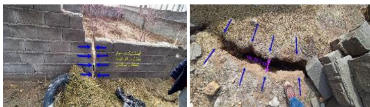
شکل ۷. الف: پراکندگی استخرهای پرورش ماهی در اطراف روستای خلج، ب، پ، ت و ث: گسترش شکاف‌های ایجادشده در شمال شرق روستای خلج، ج و چ: خسارت واردشده به ساختمان‌های موجود در شمال شرق روستای خلج، ح: پهنای شکاف‌های ایجادشده در شمال شرق روستای خلج، برگرفته از مطالعات شناسایی، اولویت‌بندی و نحوه مداخله در روستاهای در معرض خطر کشور
