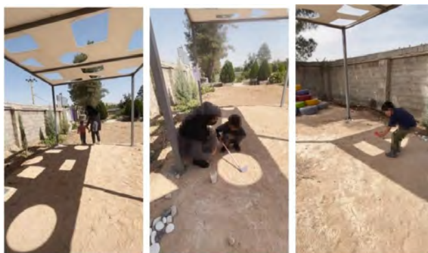
تصویر ۶. سازه چادری ساخته‌شده برای آزمون (مرکز خیریه اتیسم استان فارس، پروژه ساخت تا آزمون از اوایل مردادماه تا مهرماه ۱۴۰۱). مأخذ: آرشیو نگارندگان.
