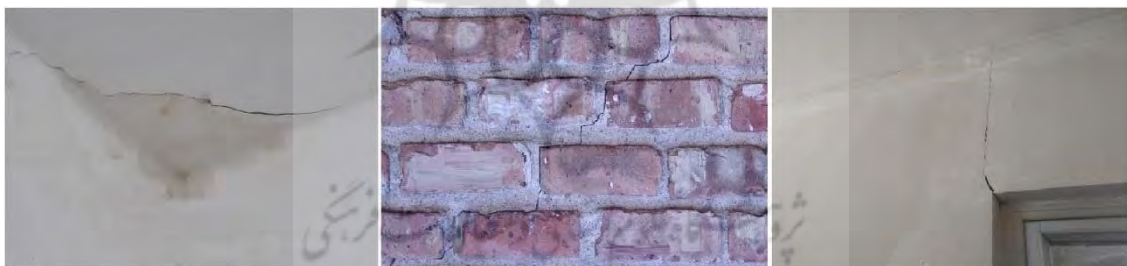
شکل ۶: ترک‌های شکل گرفته ناشی از فرونشست در شهر نمین
