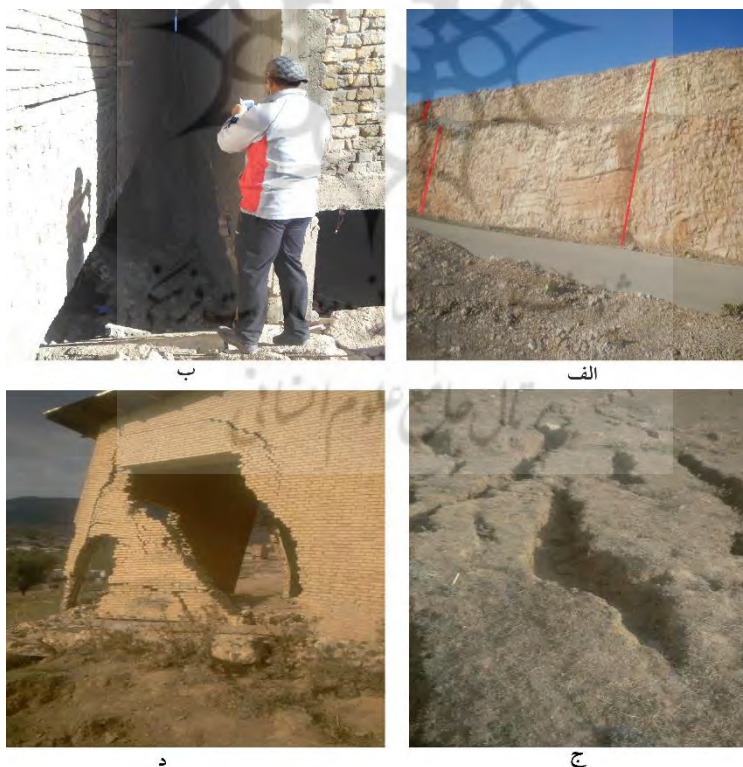
شکل ۱۲: الف: تصویر گسل‌های عادی سنگ بستر آهکی در پشت تاج لغزش و در مجاورت سد، ب: ظهور چشمه در زیرزمین منازل مسکونی، ج: ترک و شکاف‌های عرضی در خاک رس منطقه و د: کف بالآمده ساختمان ورزشگاه، که سبب ریزش دیوار و سقف شده است.
