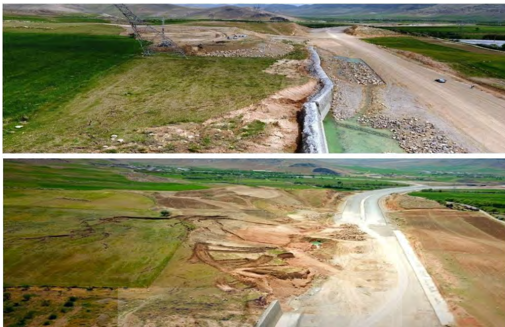
شکل ۲- تصاویری از وقوع زمین لغزش در حین و بعد از عملیات ساخت آزادراه
