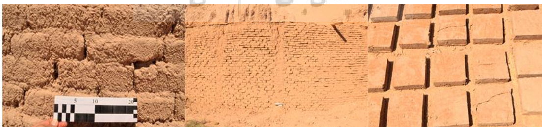
شکل ۳: فرسایش خشت‌ها و ساختار دیوارها در محوطه تاریخی بلقیس Fig. 3: Erosion in adobes and walls structure in Belqis Historical Site
