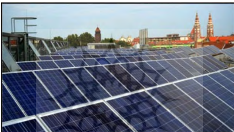
شکل ۲: پنل‌های خورشیدی در سقف ساختمان‌های دانشگاه سیگد (Gyarmati, 2018)
