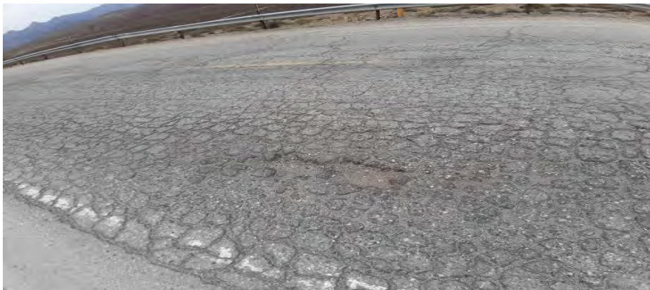
شکل ۱۱: برخی از خرابی‌های روسازی محور شاهرود - آزادشهر
