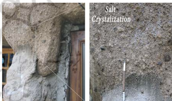
ت ۵. شکستگی نمک حاصل از کاربرد وسیع سیمان در عایق کاری و پوشش معماری صخره‌کند.
