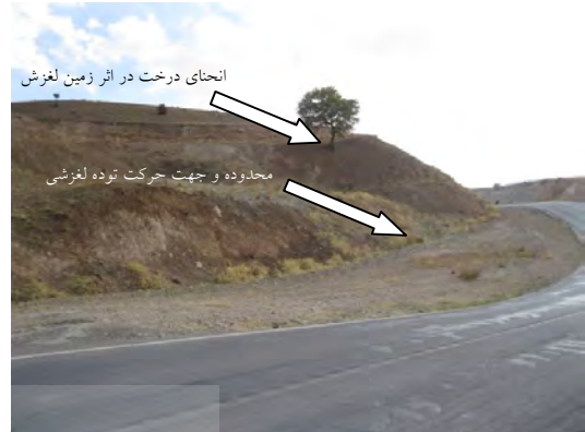
ت 2. نمایی از آثار حرکت زمین در کیلومتر 15+350 (دید به سمت شمال شرق).
