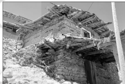
ت ۸. تفاوت در جنس مصالح دیوار در طبقه همکف و طبقات فوقانی
