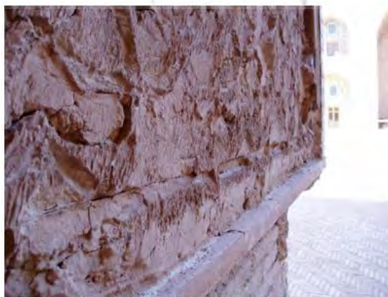
تصویر ۴: نمونه آسیب دیدگی دیواره شمالی ایوان جنوب غربی مدرسه غیائیه خرگرد. مأخذ: (نگارندگان، ۱۳۹۸)
