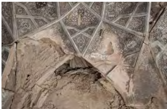
تصویر ۳- عکس از فروریختگی دیوار اطاق منقوش که زیرکار و روکار و روش نقش‌اندازی در آن مشخص است.
