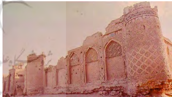
تصویر ۱: نمایی از کنج شمال شرقی رباط سپنج که برج تخریب شده و بخش‌هایی از تزیینات و کتیبه فوقانی بنا در آن دیده می‌شود (کیانی و کلایس ۱۳۷۳).
