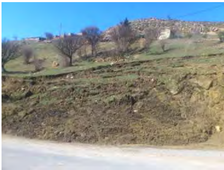
شکل ۴- وقوع زمین لغزش ناشی از احداث جاده و از بین رفتن تکیه گاه دامنه شیب دار (منبع: نگارندگان، ۱۳۹۹)
