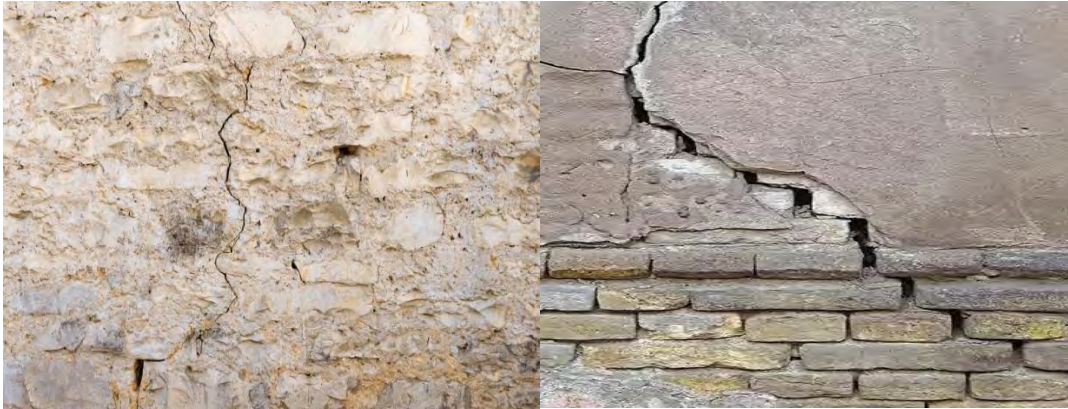
شکل ۷: ترک‌های شکل گرفته ناشی از فرونشست در دشت اردبیل
