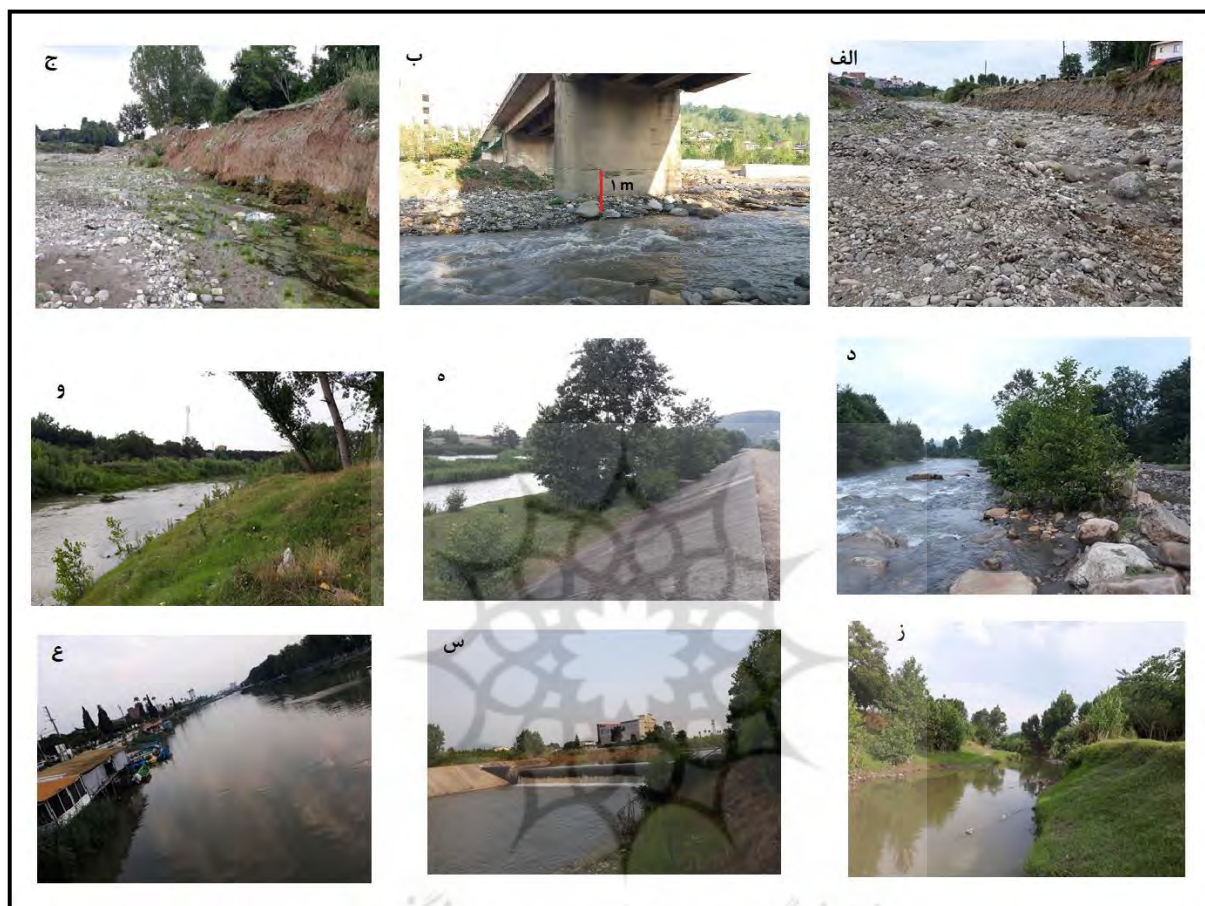
شکل ۳: الف) بستر و کرانه آبرفتی بازه ۱، ب) فروسایی بستر در پایه پل در بازه ۱، ج) پسروری کرانه آبرفتی در بازه ۲، د) بستر بازه ۳، ه) دیوار حفاظتی در بازه ۴، و) بخشی از بازه ۵، ز) کرانه و بستر بازه ۶، س) وجود سد لاستیکی در بازه ۷، ع) تجاوز به حریم رود در بازه ۸.
