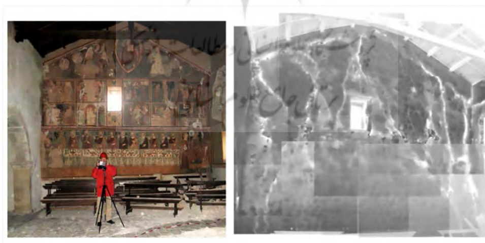
شکل ۸. نقاشی دیواری در معرض خطر زلزله: تشخیص لایه‌لایه شدن و ترک‌های ساختاری توسط ترموگرام منبع (Grinzato, 2012)
