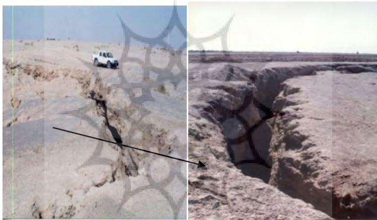
شکل 1- حفره‌ی بلعنده، یکی از فروچاله‌های روستای فیض آباد ابرکوه
