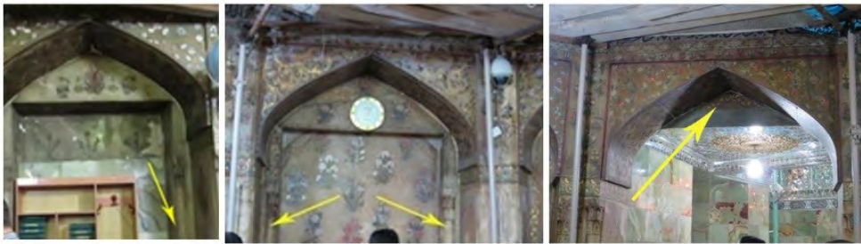
شکل ۶: (راست): ورودی جدید در سمت شمال غربی بقعه. (بخش جداشده دیوار به خوبی دیده می‌شود)؛ (وسط): دیوار اضافه شده به بخش جنوبی بقعه؛ (چپ): ورودی مسدود شده غربی (در تصاویر وسط و چپ، گلدان و ستون‌های بخش داخلی ورودی‌های مسدود شده با فلش مشخص شده است).
