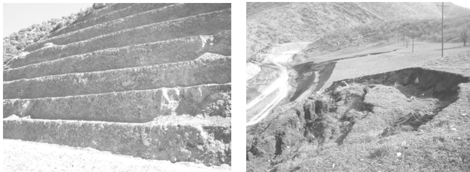
شکل ۳- نمونه‌ای از لغزش ایجاد شده در بالادست ترانشه راه (راست) و ایجاد ترانشه‌های پلکانی (چپ) برای پایدارسازی دامنه مسلط به جاده
