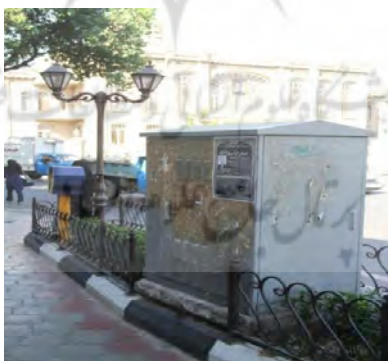
شکل (۱) عدم جانمایی تابلو‌اعلائات و استفاده از فشار برق به جای آن
