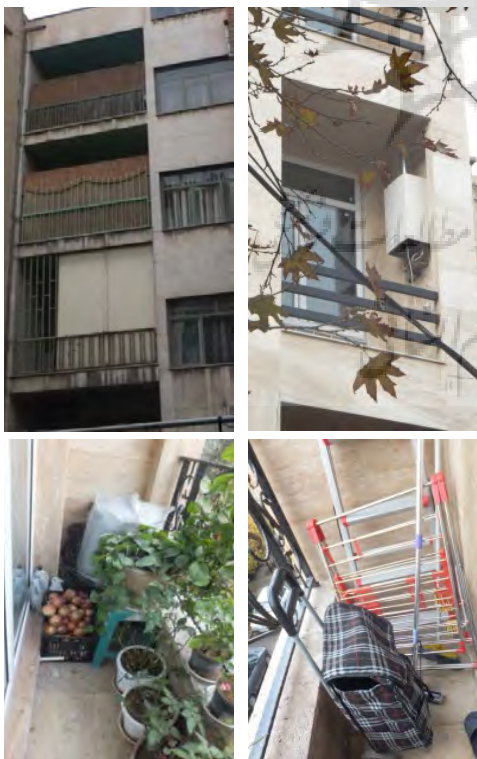
شکل ۷. ناکارآمدی تراس‌های موجود و اختشاش سیمای ساختمان
