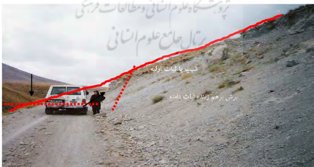
شکل (۶) خطر وقوع ریزش های سنگی در جاده ای واقع در کمرکش ارتفاعات متشکل از مواد آذر آوری در بخش اعظم سال (انتتهائی ترین جاده در بخش غربی حوضه)
