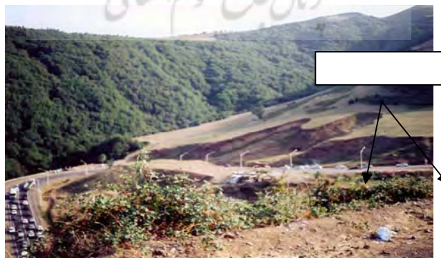
شکل ۳: افزایش تنش برشی و کاهش مقاومت برشی در دامنه های روبه شمال، به دلیل نفوذ آب باران در نتیجه گسیختگی دامنه و آمادگی آن برای لغزش.
