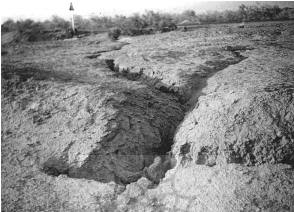
شکل ۵- شکاف به شکل شعاعی در اطراف جاده همت آباد به اشکذر
