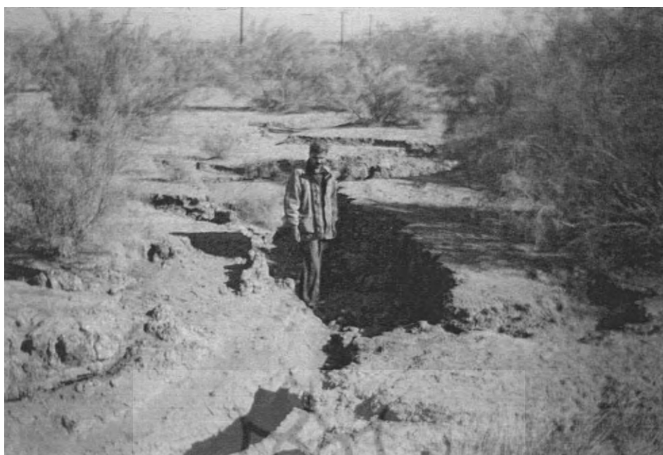
شکل ۷ - فرایند فرسایش و رسوبگذاری بادی و فرسایش آبی در منطقه که باعث تخریب لبه های شکاف های حاصل از نشست زمین شده است و شکاف تبدیل به یک آبراهه بزرگ شده است.
