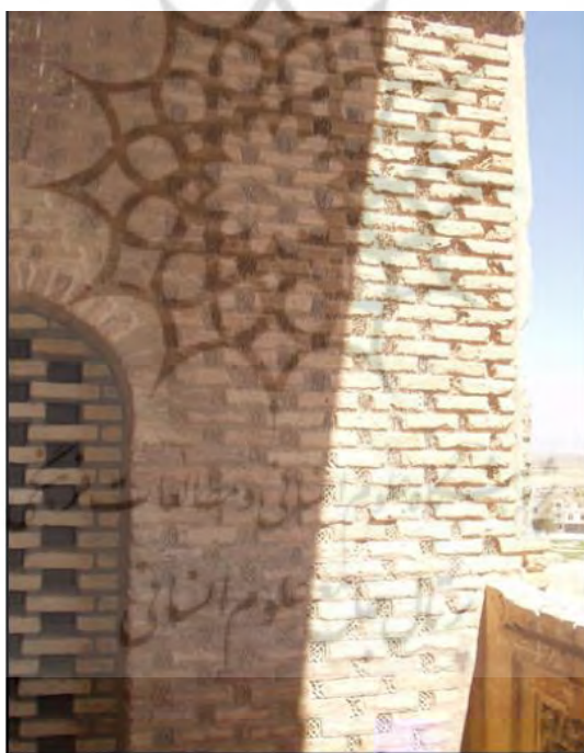
تصویر ۱۱- گستره آسیب‌دیدگی یکی از دیواره‌های طبقه دوم بنای سلطانیه
