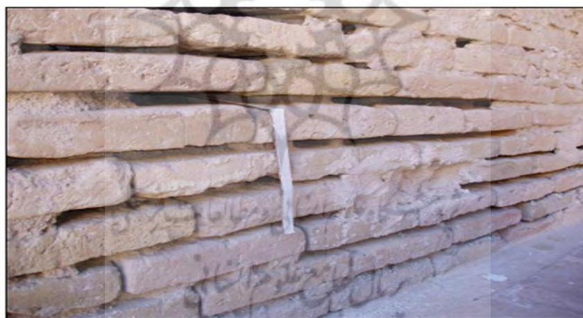
تصویر ۱۳: فرسایش ملاط گچ مابین آجرهای دیواره جنوبی ایوان غربی مدرسه غیاثیه (منبع: نگارنده‌گان، ۱۳۹۸).
