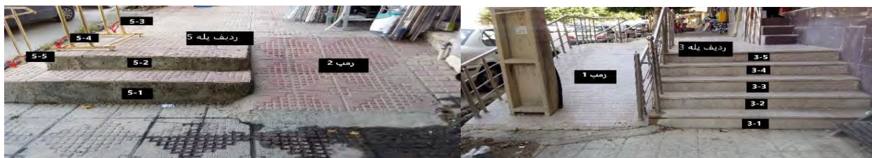
شکل شماره ۶: رعایت نکردن ضوابط در رمپ (رمپ ۱) شکل شماره ۷: رعایت نکردن ضوابط در پله و رمپ (ردیف ۵ و رمپ ۲)
