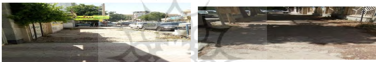
شکل شماره ۴: کفسازی نامناسب
