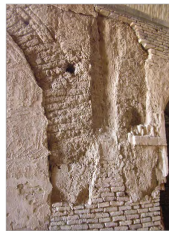
تصویر ۶. شبستان غربی، بخش شمالی جرز F2، جرز خشتی‌چینه‌ای و تویزه خشتی (نگارنده)
