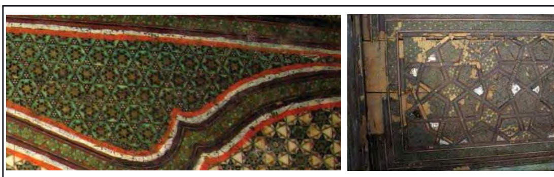
تصویر ۶، الف- بخشی از منبر خاتم‌کاری و بخش‌های آسیب دیده، ب- بخشی از منبر خاتم‌کاری، مرمت غیر اصولی-استفاده از رنگ قرمز و سفید اطراف نقوش. مأخذ: نگارندگان
