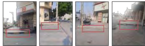
تصویر ۳. اختلاف سطح غیرمجاز پیاده‌رو و خیابان
