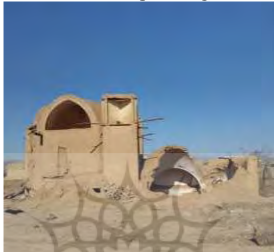
شکل ۲: تصویر حوضخانه تخریب‌شده باغ کاشانی (رضا نبی، ۱۳۹۴)
