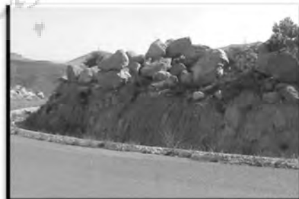
شکل (۲): وقوع حرکات دامنه‌ای در منطقه
