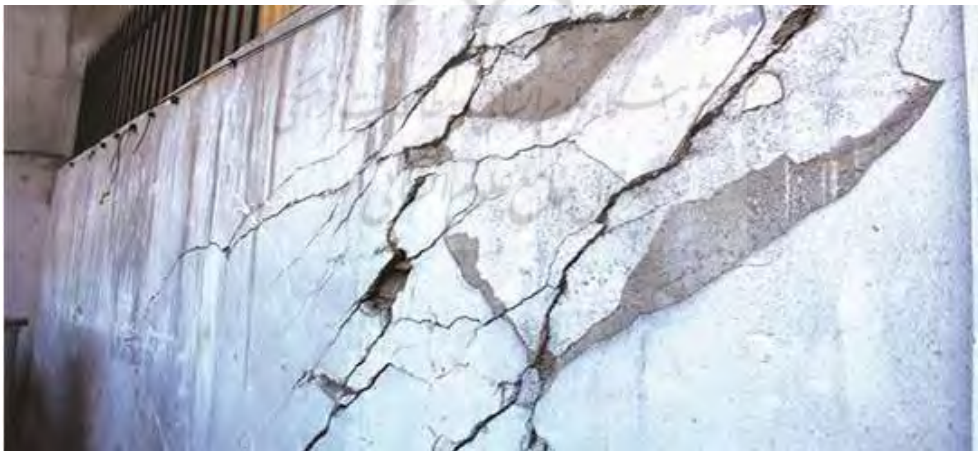
تصویر ۳. نمونه‌ای از دیوار ترک‌خورده‌ی ساکنان محله بافت فرسوده بریانک بر اثر احداث مترو
