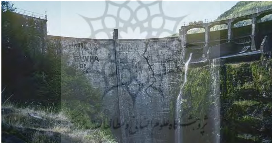
شکل ۱- آسیب دیدگی سازه‌های هیدرولیکی (منبع: https://www.wikipaper.ir )
