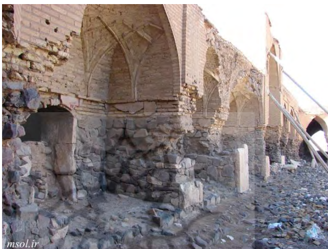
تصویر ۹: چهره بیرونی بنا و فروریختگی و جدایی قطعات سنگی و بخشی از آجرهای دیوار (برگرفته از: کتابی، ۱۳۹۰).
